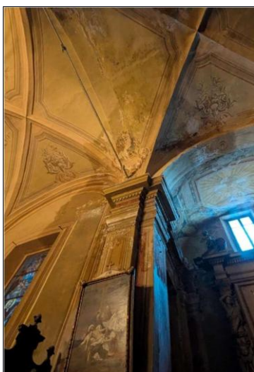
Ingresso di acqua ancora in fase liquida (dunque recente)
