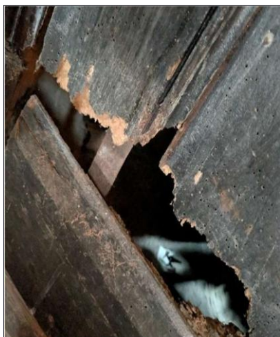
Attacchi di insetti xilofagi con perdita di materiale
