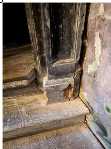
Sconnessioni, marcescenza. Si noti la situazione ben più grave degli intonaci a lato con la presenza di patina biologica.
